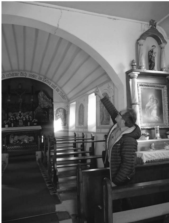
- Andreas Klotz weist auf die Schäden im Inneren der Kalvarienbergkapelle hin, die einer dringenden Instandsetzung bedürfen (Foto: Vera Stiller)
